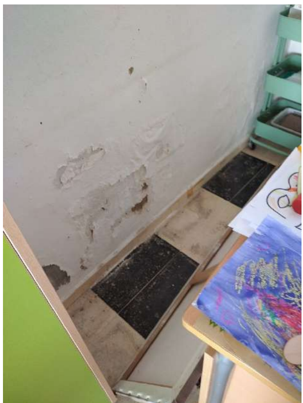
Infantil, aula i3, parament a reparar
