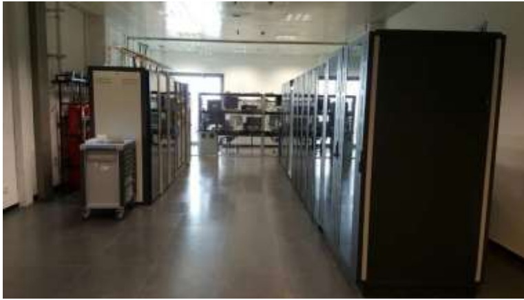
Imatge 3. Sala d'equips (planta baixa torre).
