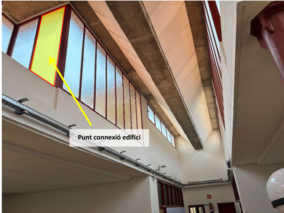
Ubicació interior conductes impulsió a claraboia
