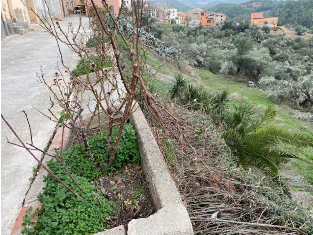
DESPLAÇAMENT DE LA VORERA DEL PAVIMENT DE LA CALÇADA PRODUINT UNA FISURA ENTRE ELS DOS ELEMENTS DEGUT AL BUIDAT DE TERRES SOTA DE LA FRANJA DEL PAVIMENT DE LA ZONA JARDINERES
