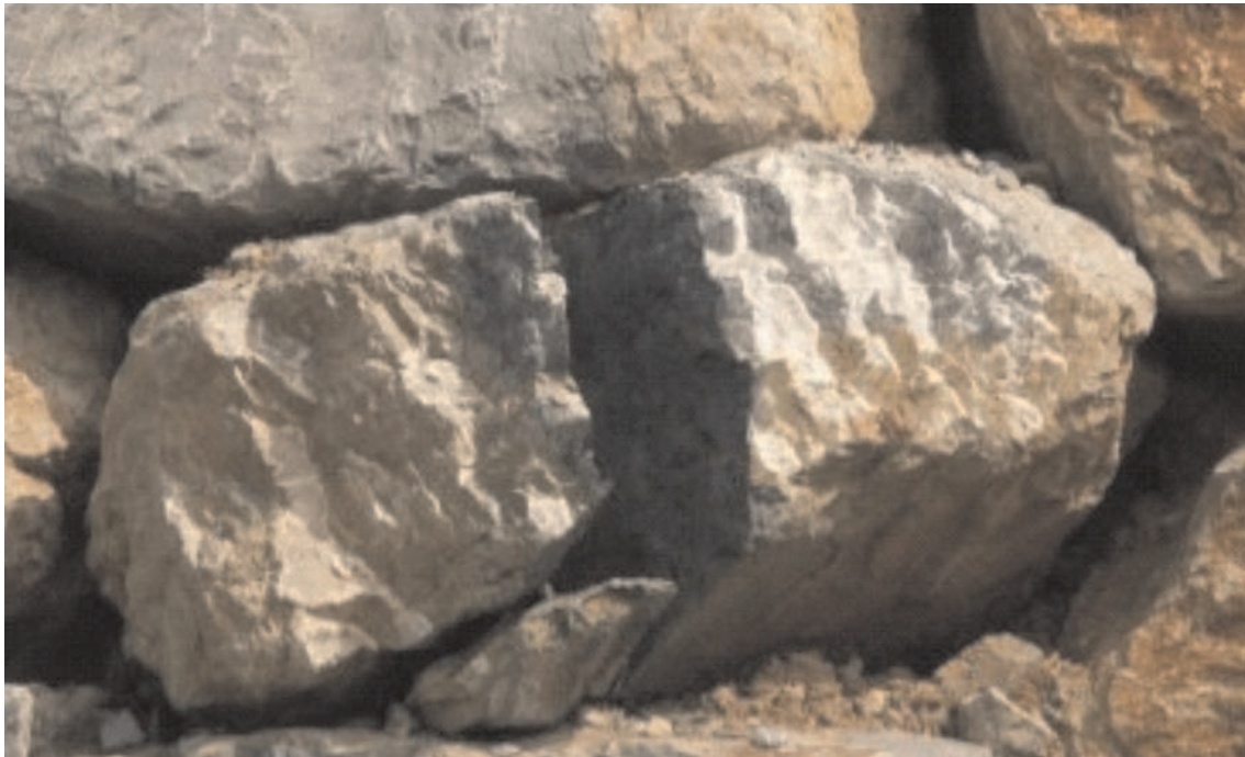
FIGURA 3.1. BLOQUE ROTO CON POSTERIORIDAD A SU PUESTA EN OBRA.
