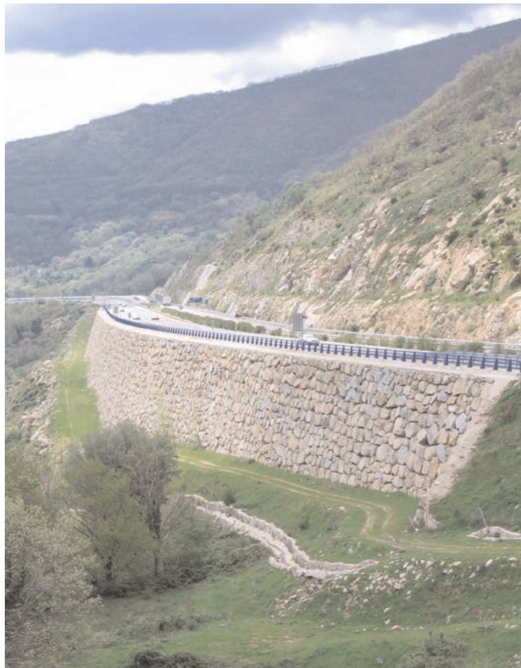
FIGURA 5.11. MURO DE ESCOLLERA DE SOSTENIMIENTO CON CAMINO DE SERVICIO AL PIE, UTILIZABLE PARA LA COLOCACIÓN DE REFERENCIAS TOPOGRÁFICAS.
