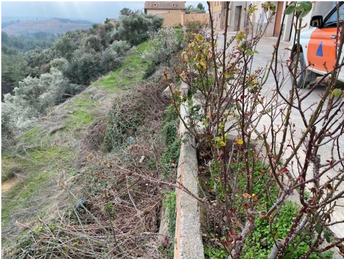
DESNIVELL DEL PAVIMENT DE LA VORERA RESPECTE A L'ALTRA COSTAT DEL TERRENY
