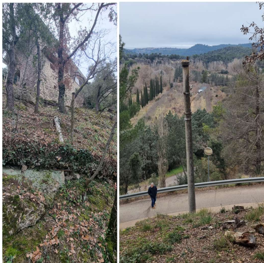
Fotografia canonada desguàs fibrociment i bàcul enllumenat
