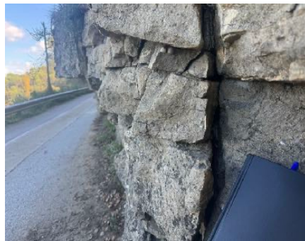
Fot. 10. Obertura de les fractures F1 i F2. Poden ser susceptibles al volcament pel que es recomana sanejar els blocs que generen o ancorar-los si és el cas.
