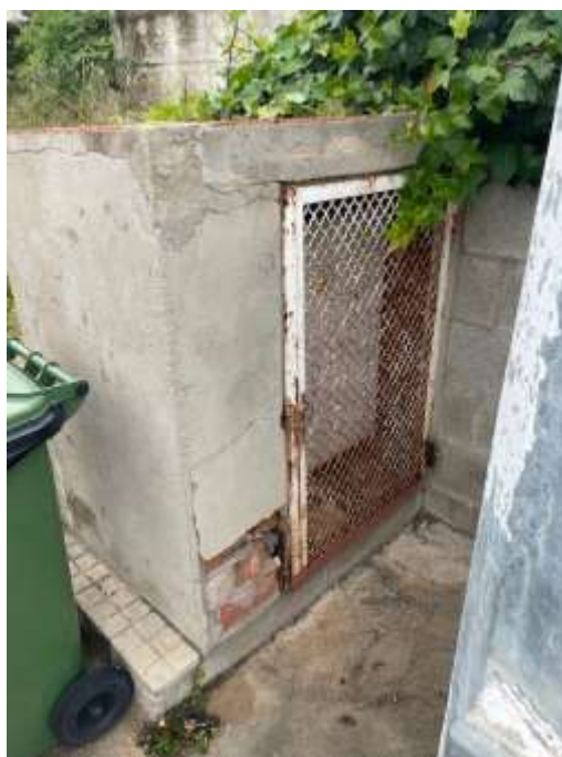
Portes de registre de la instal·lació de la lluminària del camp que s'hauran de substituir.
