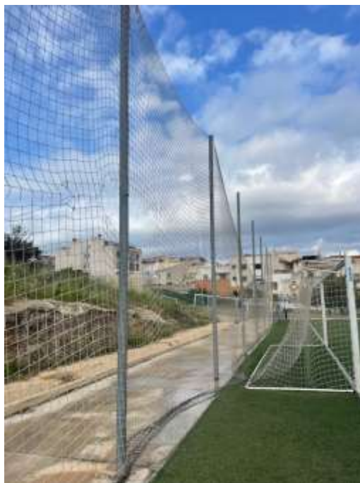
Xarxes de les porteries i de protecció que s'han de substituir.
