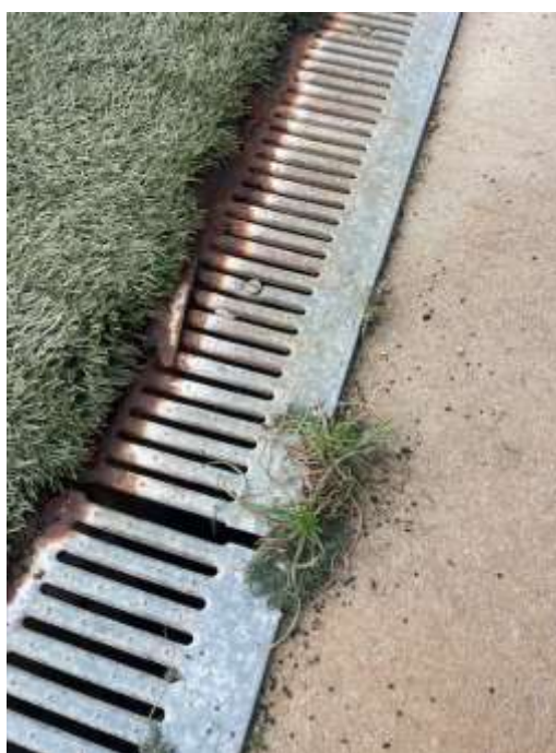
Detall reixa lateral d'evacuació a substituir.
