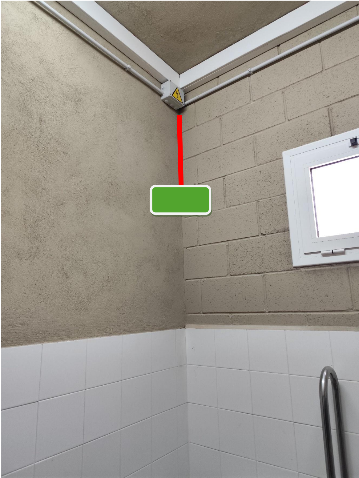
Il·lustració 4. Cambra de bany per on es traurà la línia d'electricitat. En vermell, canalització + cable i en verd, caixa de protecció.
