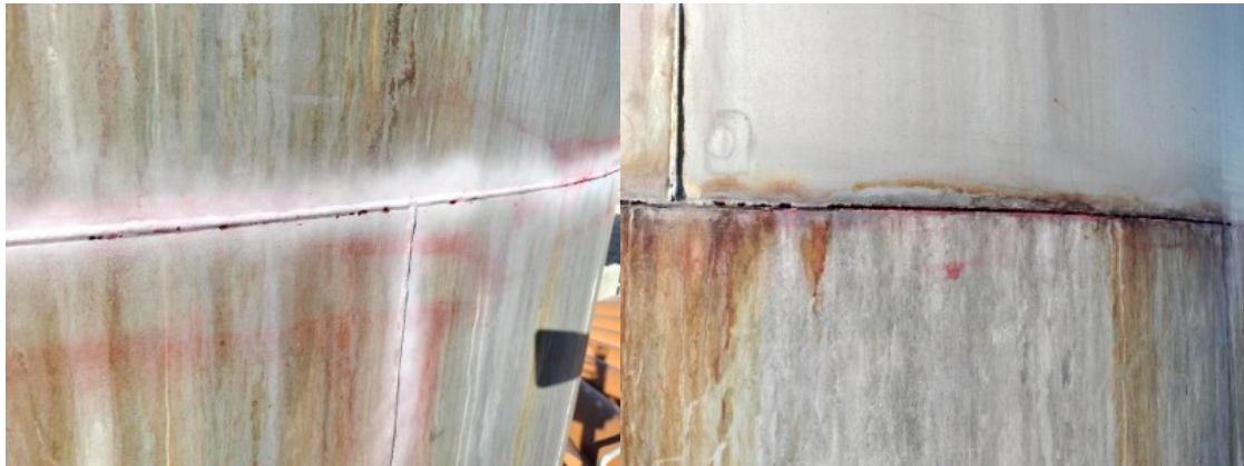
Figura 3. Estat de la soldadura 1 de la sitja.
