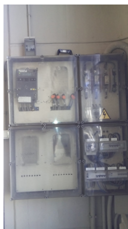
Detall quadre elèctric actual
