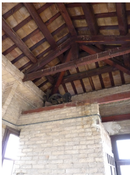
Recinte i maquinària planta altell
