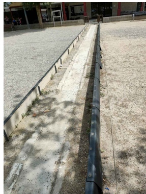
Sòcol de fusta existent, goma de cautxú de protecció a substituir
