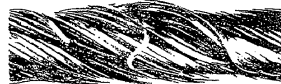
Cliché 22 - Efecto acumulativo de las alteraciones. Fuerte desgaste de los alfileres de refuerzo que han sufrido un laminado que ha provocado su afloramiento y un importante deterioro en el cable. Pueden observarse también alfileres rotos. El cable debe ser retirado inmediatamente.
