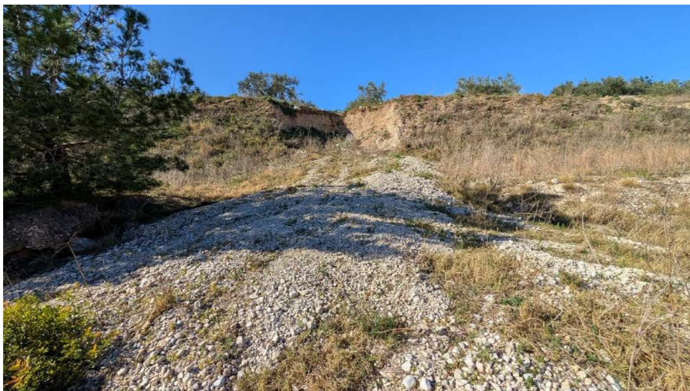
Vista frontal del punt d'erosió E2 al talús 6. La canalització de l'aigua ha generat un reguerall clarament definit, amb acumulació visible de sediments a la base. Aquest procés erosiu pot evolucionar i afectar de forma regressiva el marge superior i les finques veïnes si no es corregeix.
