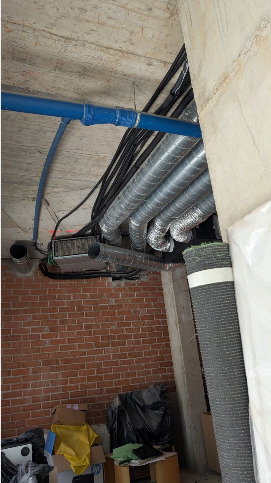
Zona d'instal·lacions a la planta baixa amb conductes visibles. Zona a on aniran els nous banys projecte no inclòs en el present projecte.
