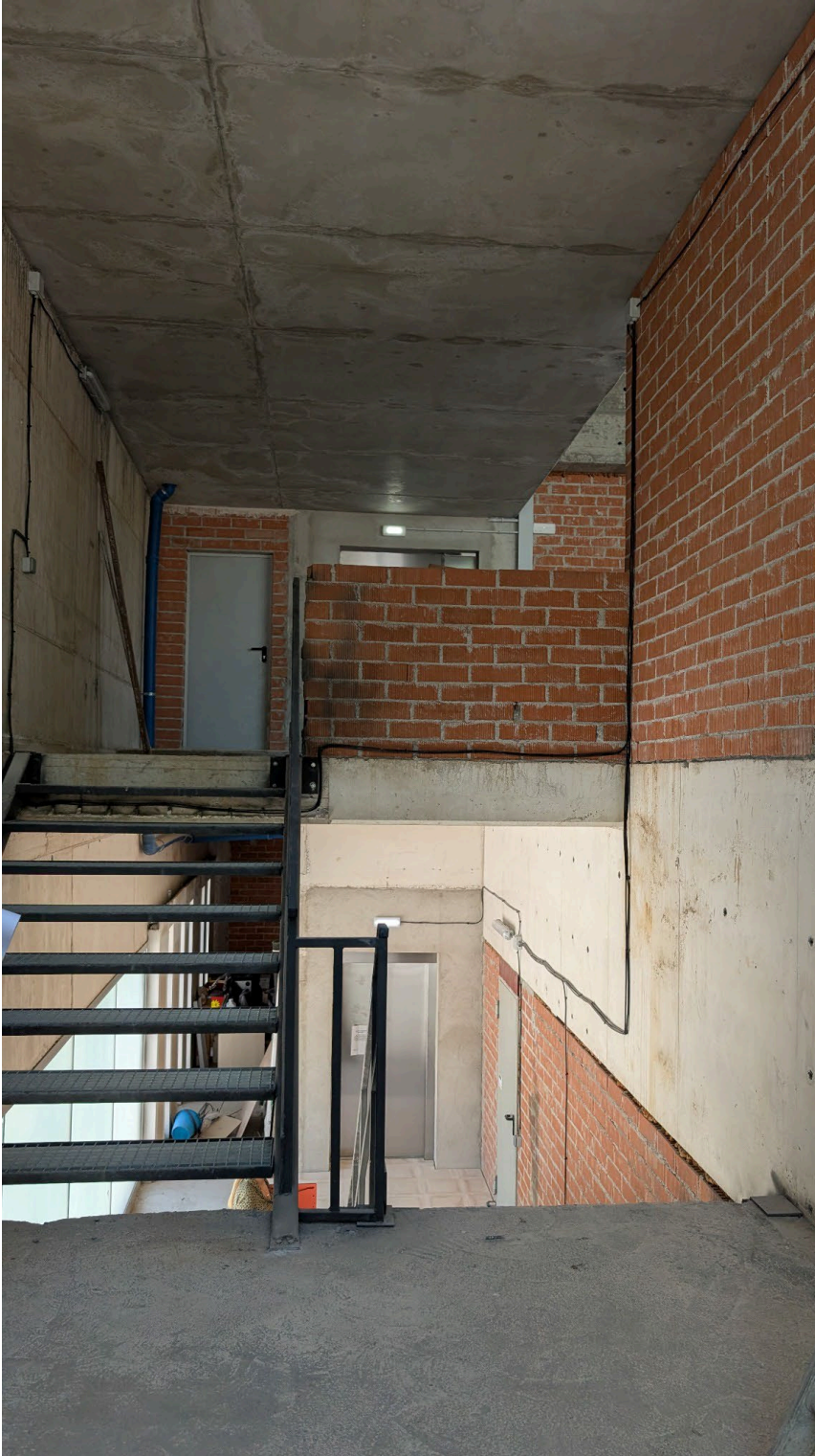
Vista de l'escala interior metàl·lica i l'accés a la planta primera. No s'observen les esperes de l'escala. Les platines d'inici traslladen la càrrega molt puntualment.
