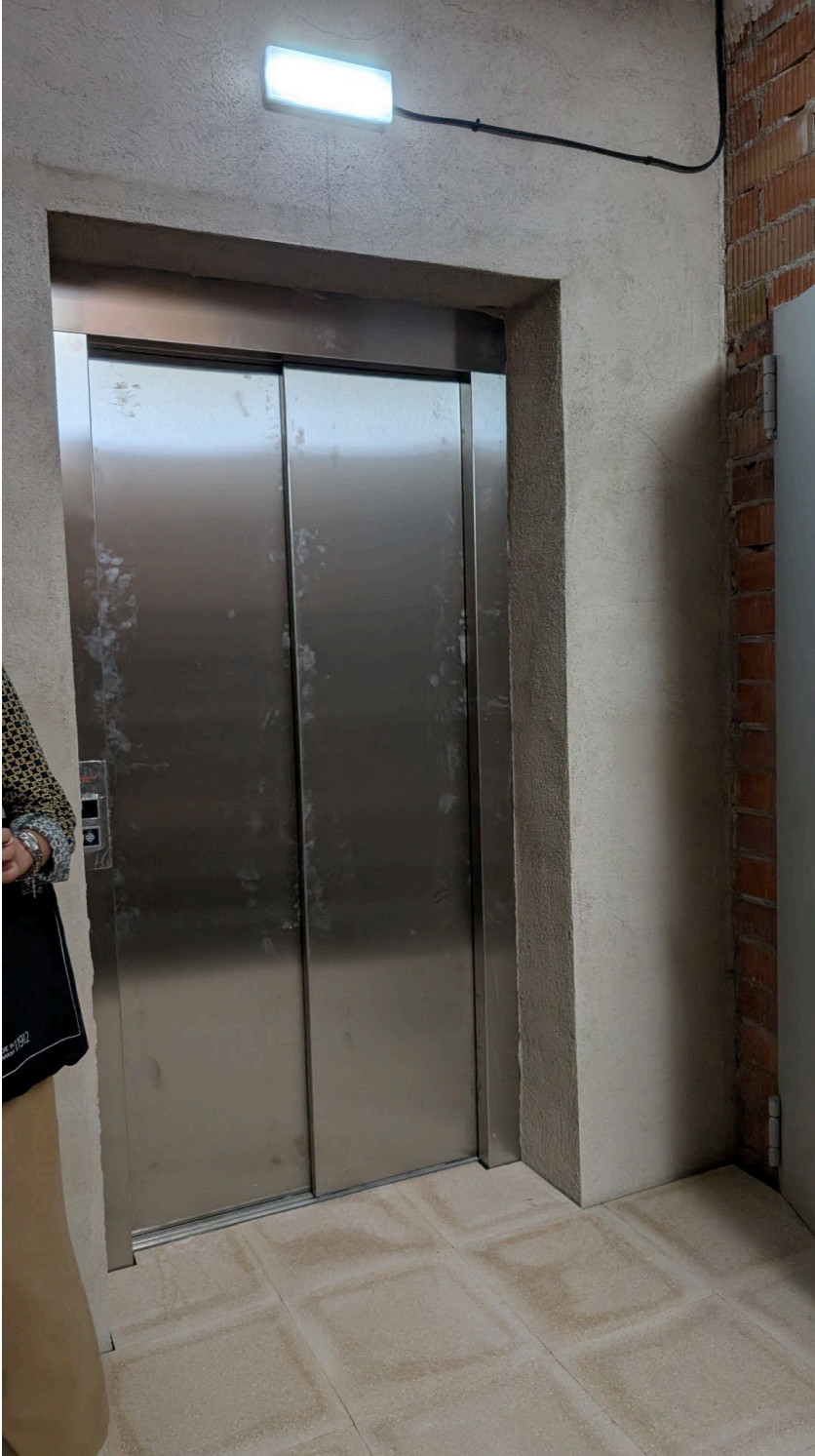
Ascensor ja instal·lat i en funcionament, ubicat a l'interior de l'edifici.
