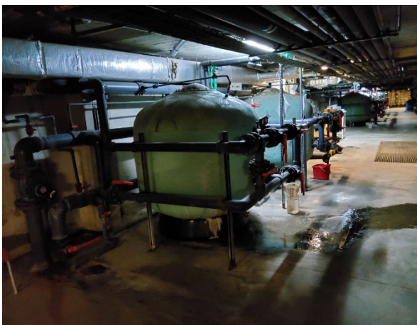
Foto 4. Filtres piscina petita (2 ut.)
