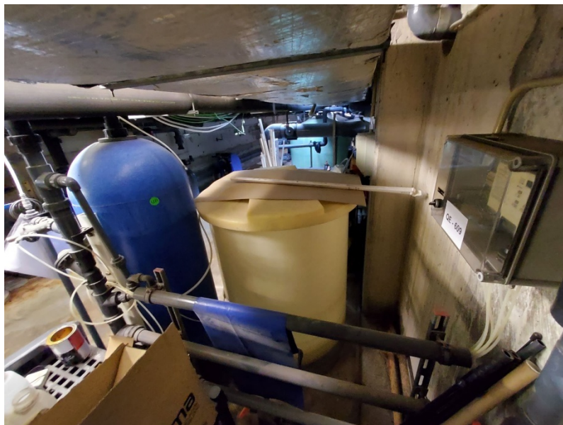
Foto 1. Descalcificador fora de servei
