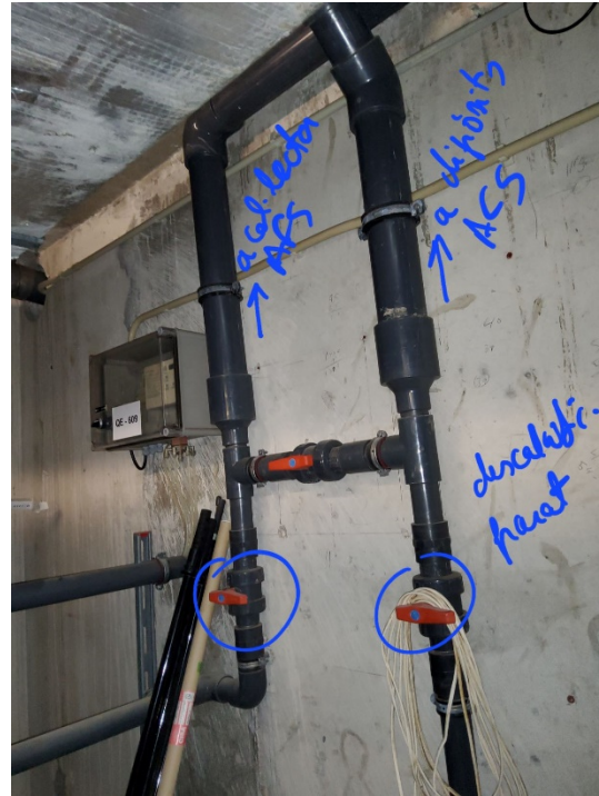
Foto 3. By-pass descalcificador fora de servei
