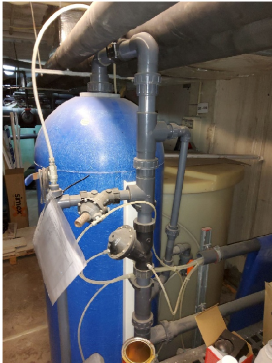
Foto 2. Descalcificador fora de servei
