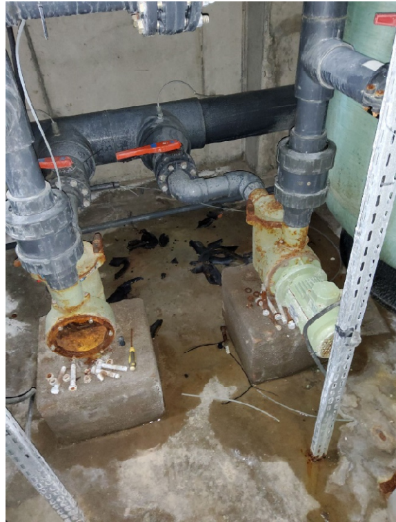
Foto 7. Bomba i prefiltrre piscina gran fora de servei
