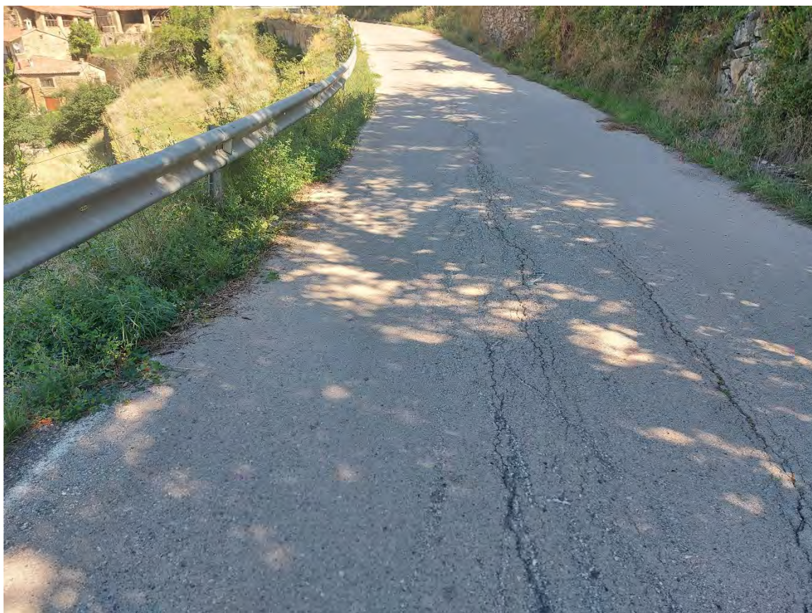
Fotografia núm. 10 - p.k. 1+450 Reparació de rotura calçada 34 m
