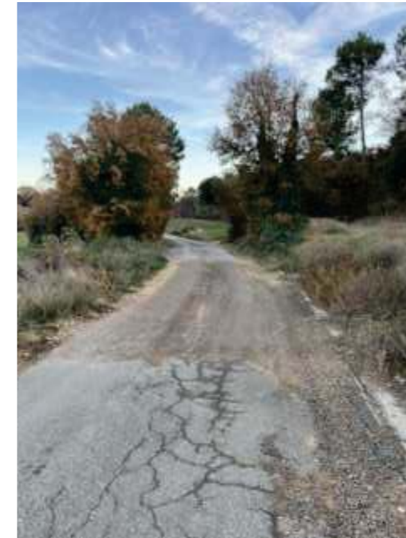
Figura 5. Tram del camí amb esquerdes
