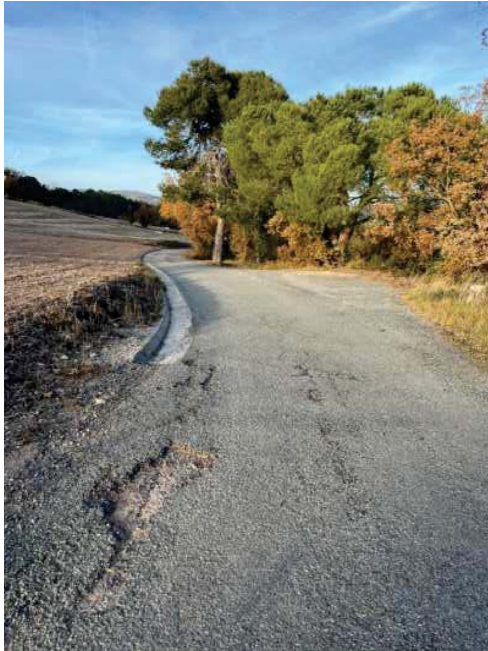
Figura 5. Part del tram amb enfonsament i cuneta existent (Punt 4)
