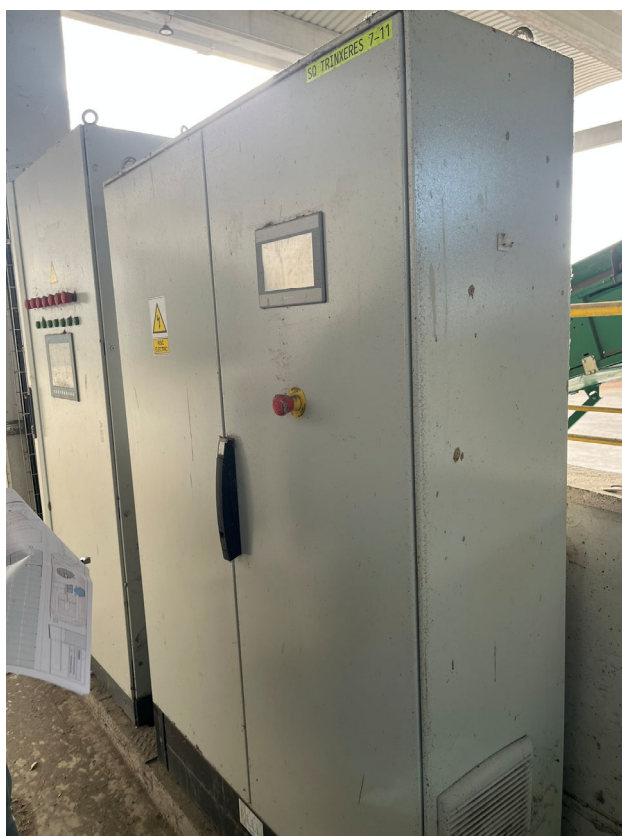
Fotografia 7 Vista general de l'armari del subquadre dels ventiladors 1-6 de les trinxeres d'estabilització.
