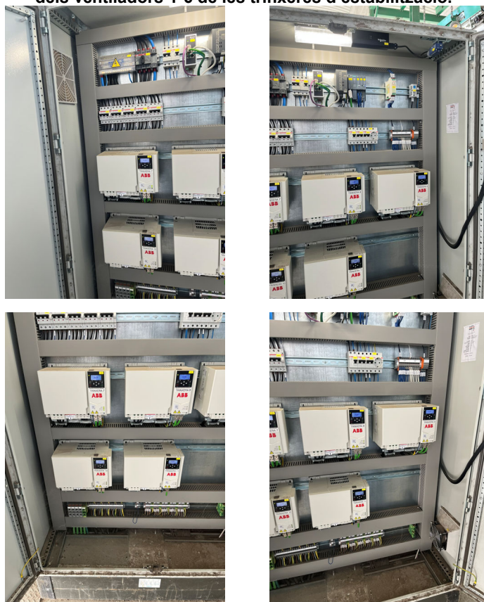
Fotografia 8 Composició de la vista interior de l'armari del subquadre dels ventiladors 1-6 de les trinxeres
