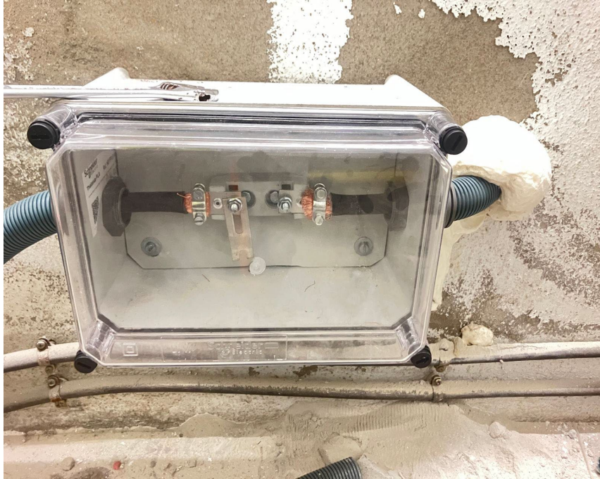
Caixa tipus de seccionament instal·lada.
