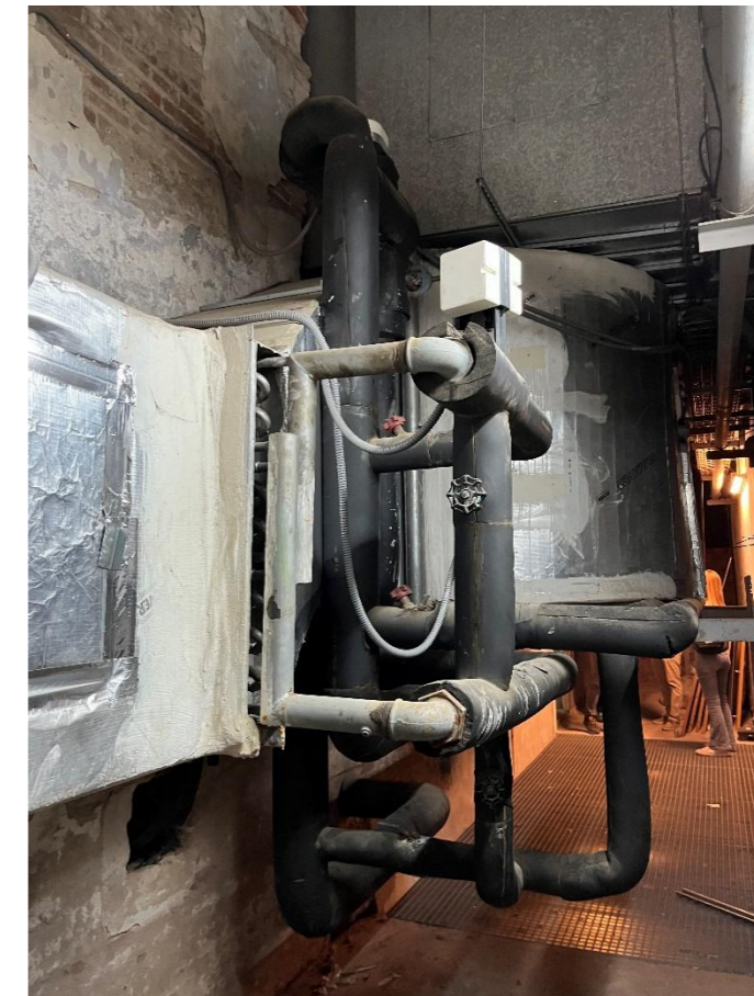
Distribució de conductes i bateria de calor del climatitzador de servei de la biblioteca
