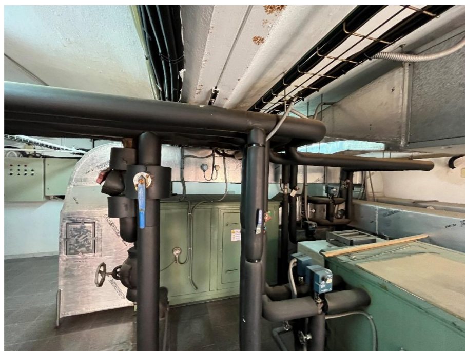
Climatitzadors de sala tècnica amb accés des de zona de revistes
