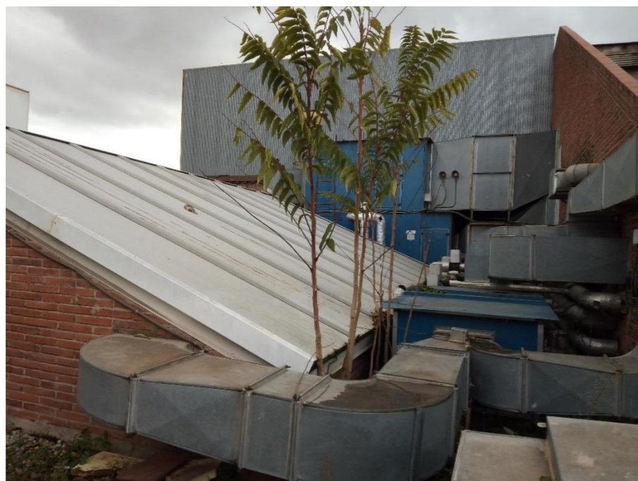
Climatitzadors ubicats a la coberta de la planta tercera
