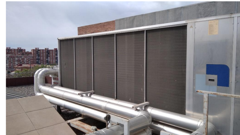
Equip de producció de fred i calor ubicat a la coberta de l'edifici
