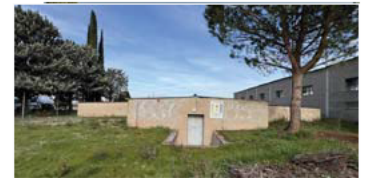
VISTA DIPÒSIT D'AIGUA SEMISOTERRAT
