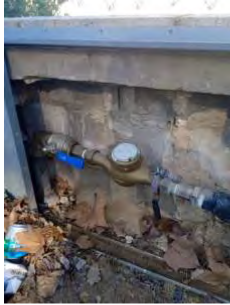
Comptador d'us industrial existent
