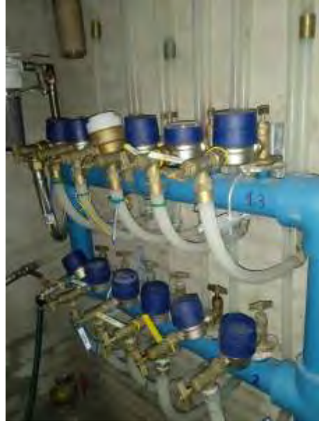
Bateria de comptadors existent
