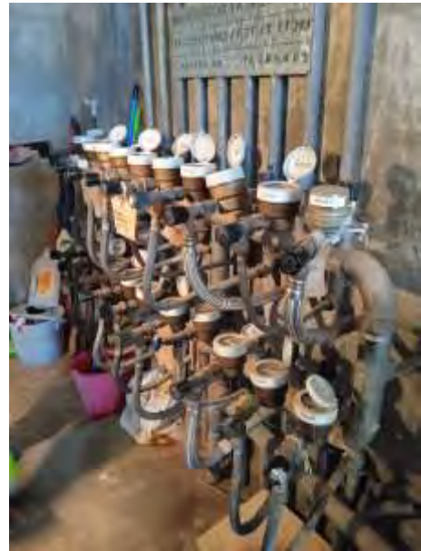
Bateria de comptadors existent
