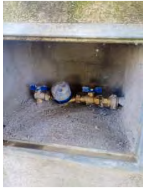
Portella existent amb comptador a l'interior
