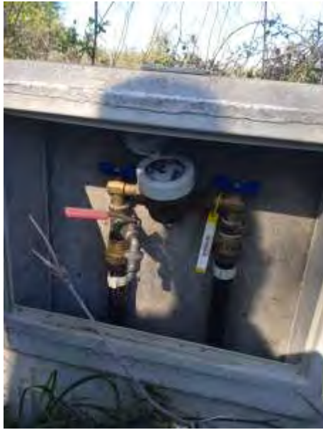
Portella existent amb comptador a l'interior
