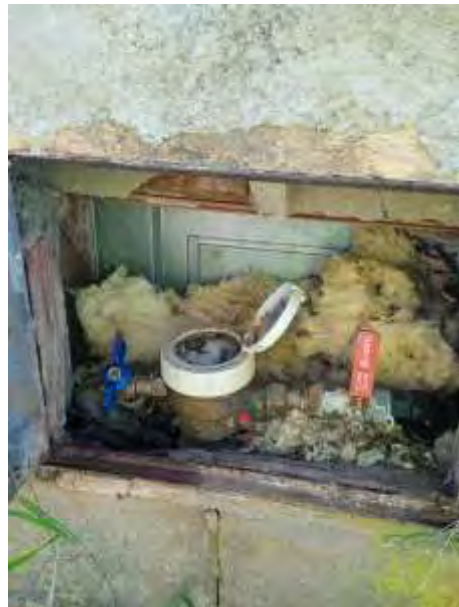
Portella amb comptador en mal estat
