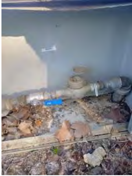
Comptador de servei contra incendis existent
