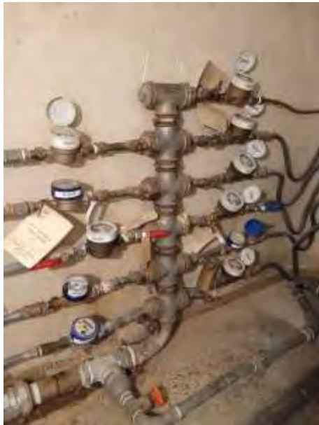
Bateria de comptadors existent
