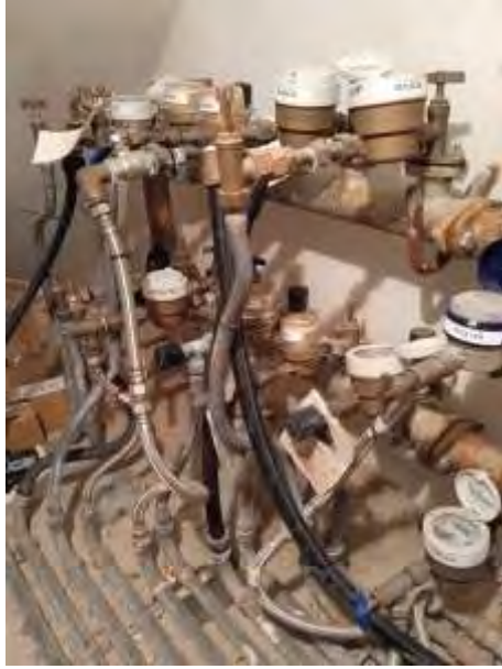
Bateria de comptadors existent
