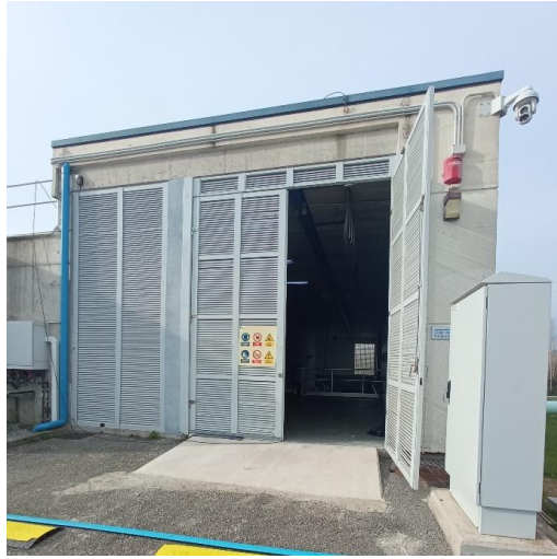
Imatge 3 Portes afectades edifici aigua producte
