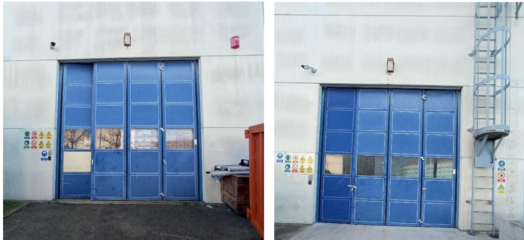
Imatge 4 Portes industrials accés principal nau de procés
