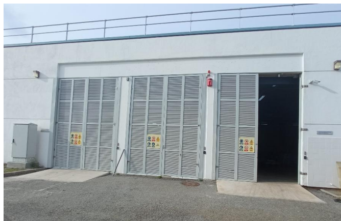
Imatge 2 Portes afectades edifici de Reactius
