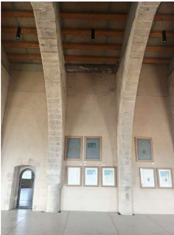
3. Imatges de les filtracions a la sala Gòtica
