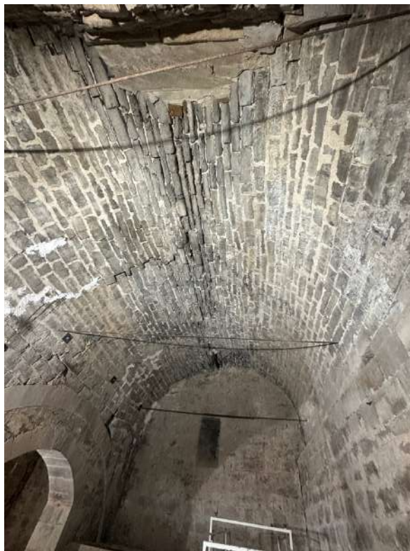
Detall de l'estat de conservació de la volta de la sala I.
