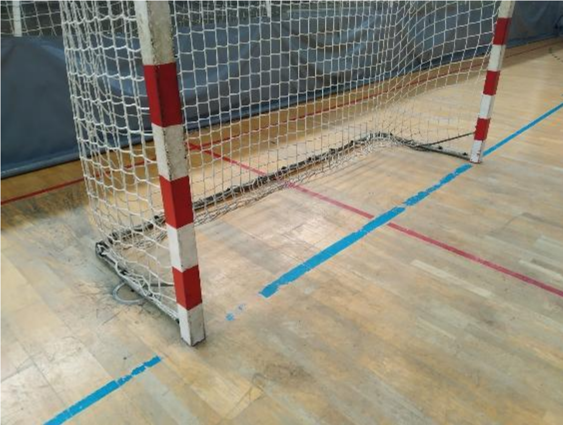
Estat del paviment a la zona de la porteria de handbol – futbol sala.
