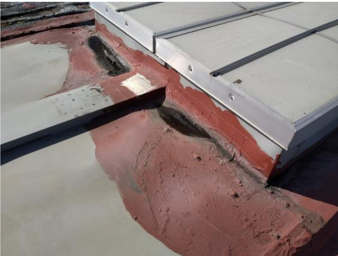
Coberta de la pista poliesportiva: acumulació d'aigua a la zona superior dels exutoris.
