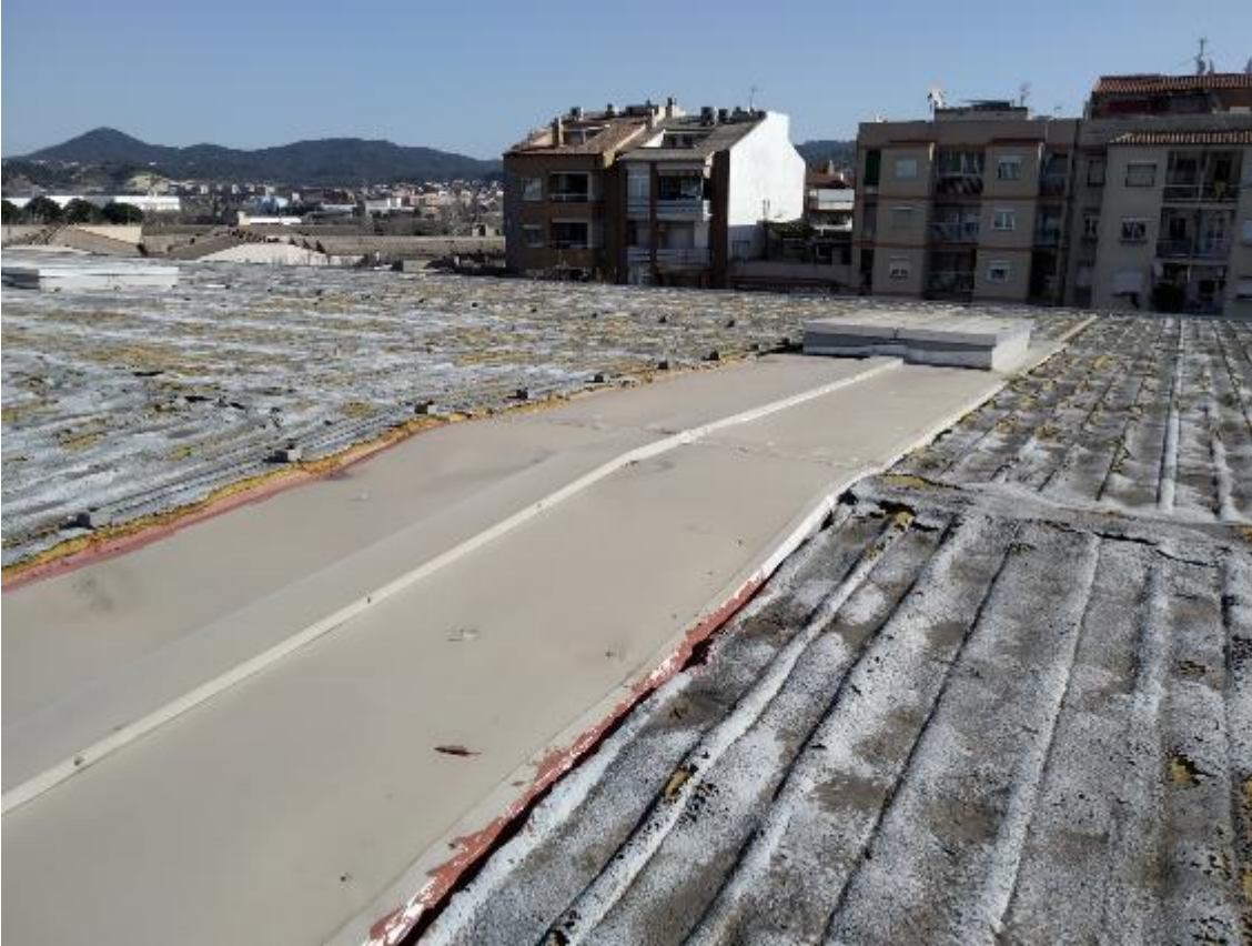
Coberta de la pista poliesportiva: xapa superposada zona exutoris.
