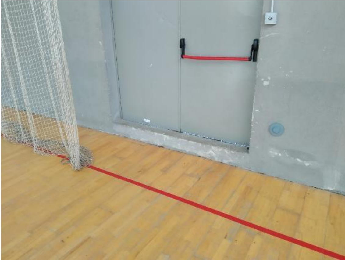
Desnivell paviment existent amb sortida d'emergència.
