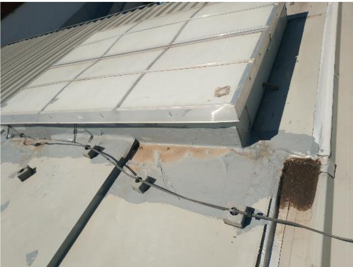
Coberta de la pista annexa: vista exutori amb acumulació d'aigua.
