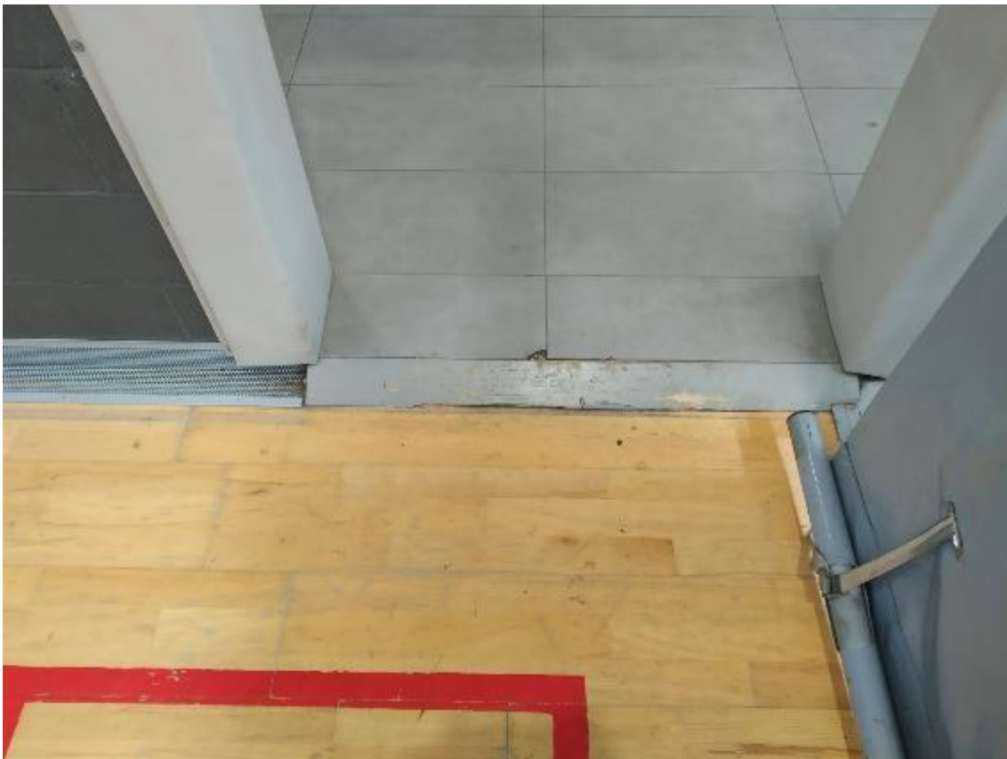
Desnivell paviment existent amb passos interiors de vestuari i accessos.
