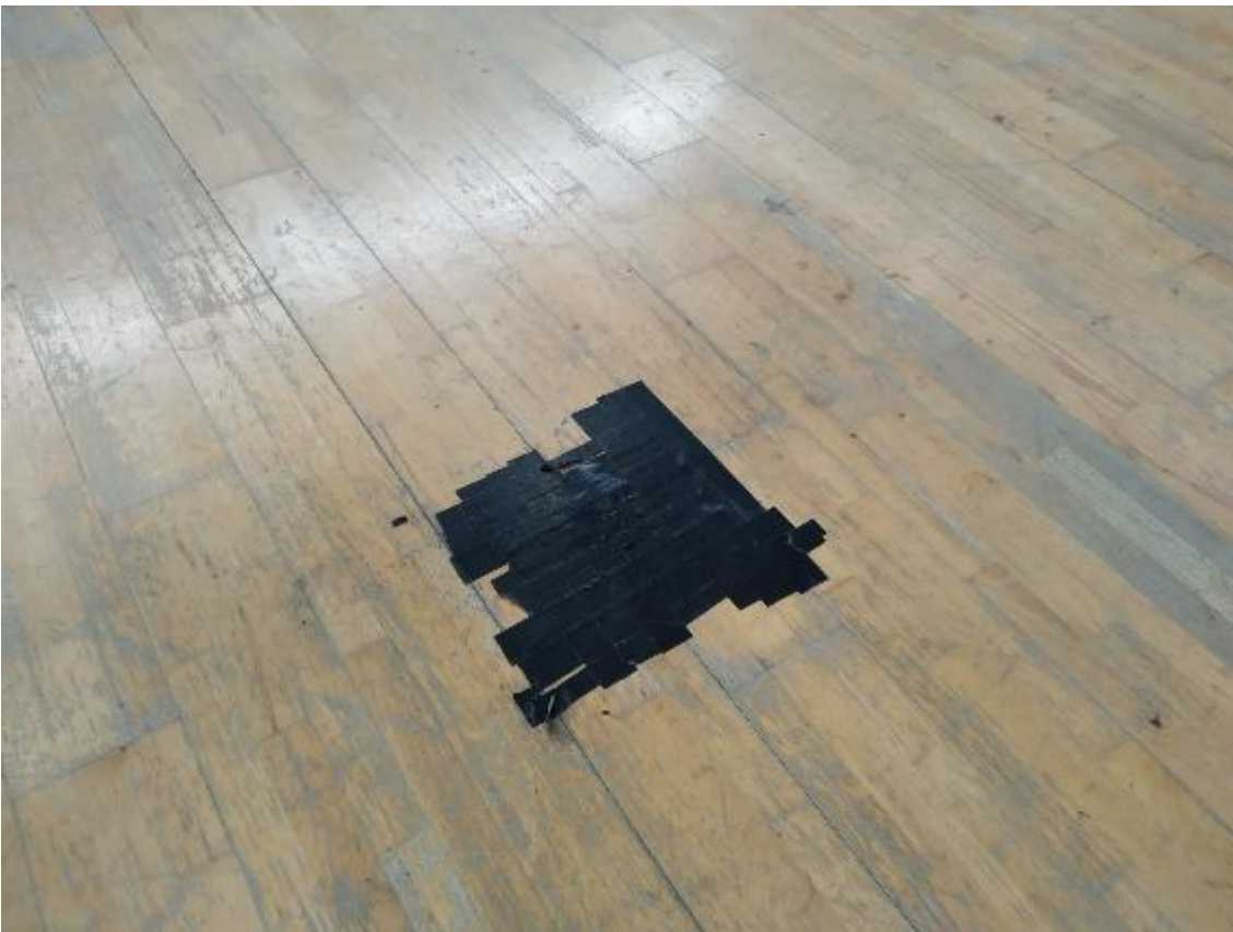
Arranjaments del parquet i zona mullada per una gotera
