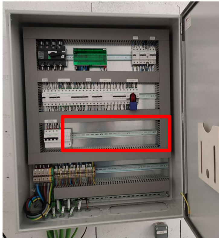
Figura 9 Espai per muntar les connexions de fibra
