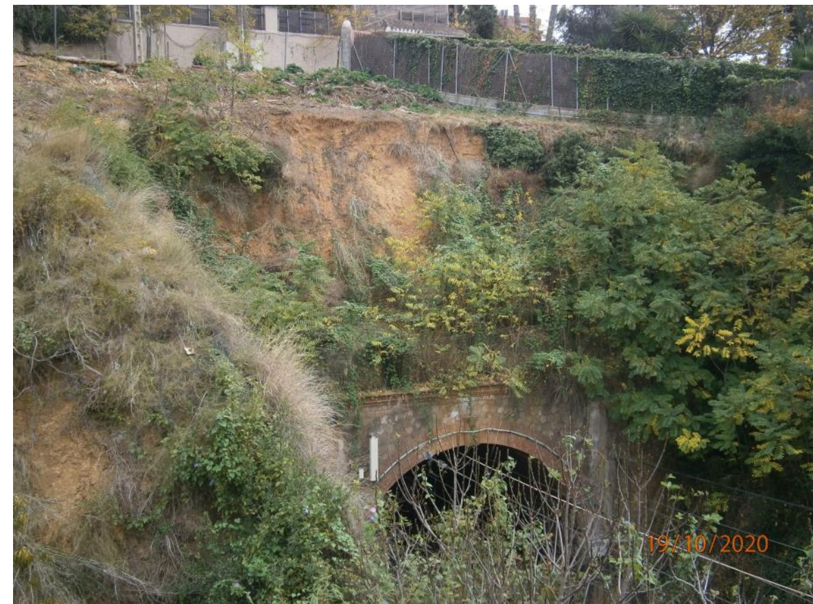
Talús sobre l'embrocament del túnel de Sarrià
