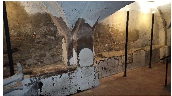
IMATGE 10. Degradació revestiments PB
