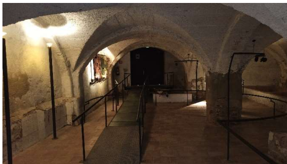
IMATGE 11. Degradació revestiments PB
