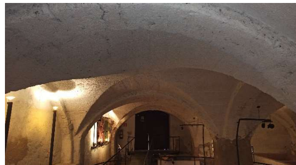
IMATGE 14. Degradació revestiments PB
