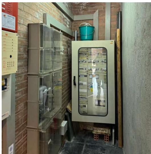
IMATGE 21. Sala tècnica
