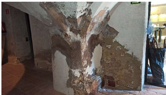
IMATGE 13. Degradació revestiments PB
