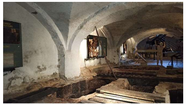
IMATGE 12. Degradació revestiments PB
