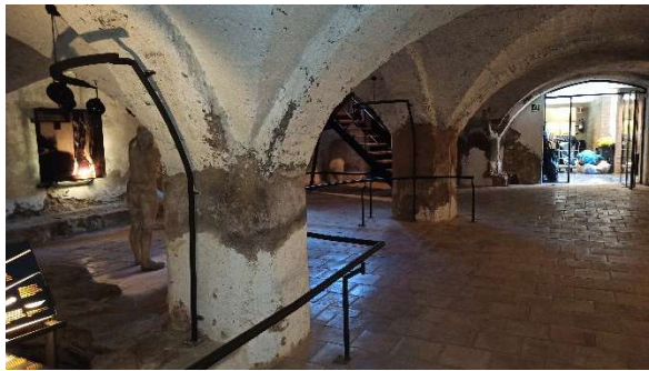
IMATGE 09. Degradació revestiments PB
