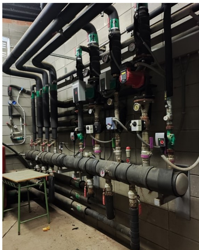
Col·lector de calefacció
