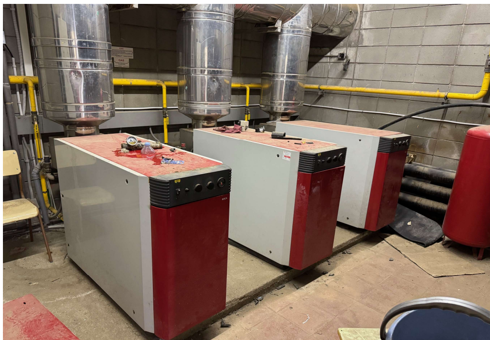
Calderes existents en sala calderes principal. Planta Baixa. Potència instal·lada 378kW.
