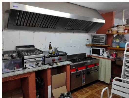
1 u. campana extractora MAC-RIN
