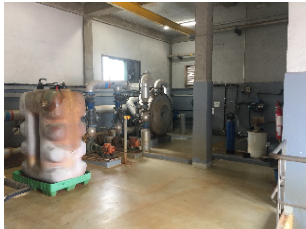
BOMBES I RECUPERADOR DE CALOR
