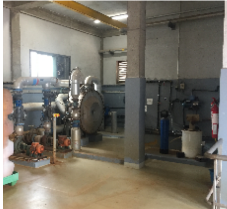
BOMBES I RECUPERADOR ESTAT ACTUAL
