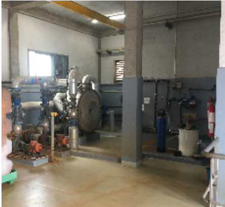
BOMBES I RECUPERADOR ESTAT ACTUAL
