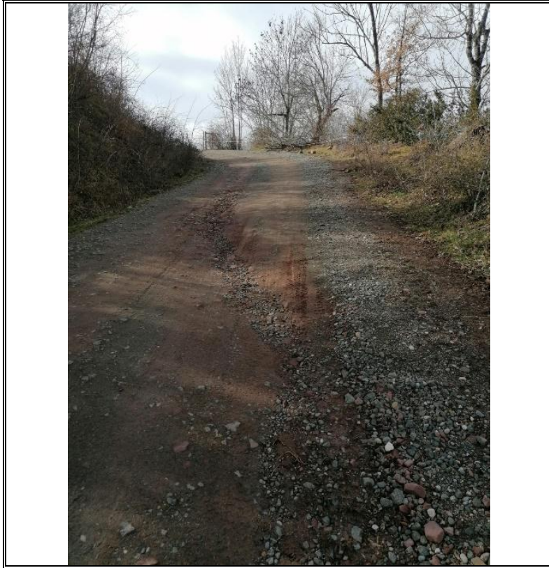
Figura 3. Vista del gener de 2025 dels xaragalls per escorrentia superficial que es generen a l'accés d'Erta.
