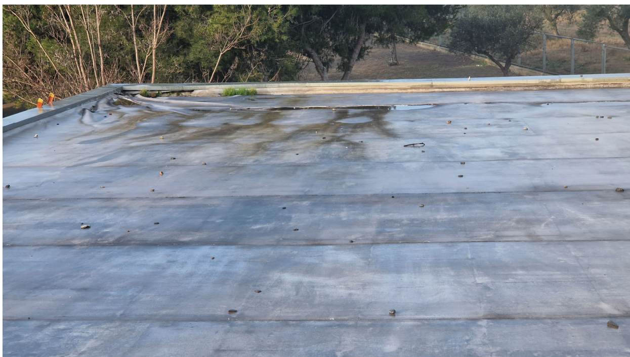
Zona canaló, làmina rebregada
