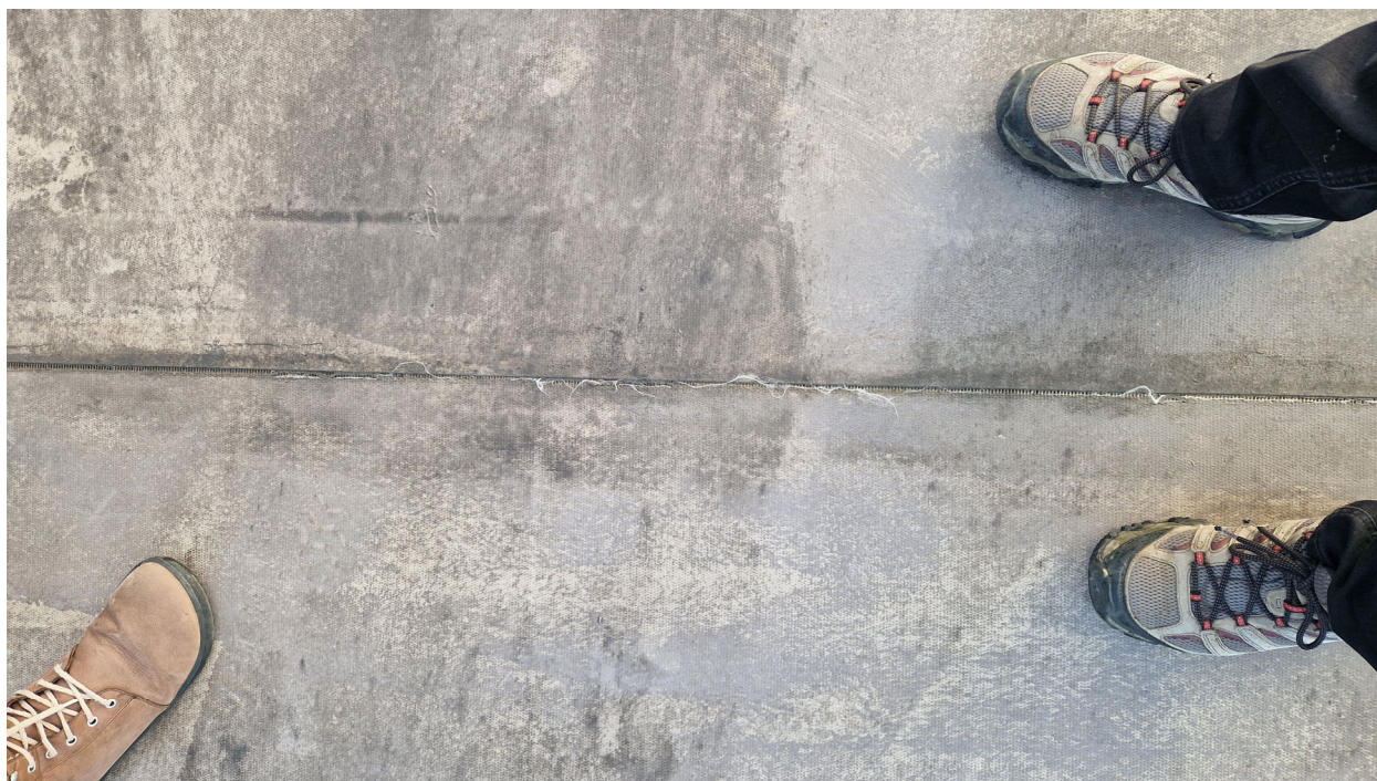
Estat de les làmines a diversos punts de coberta
