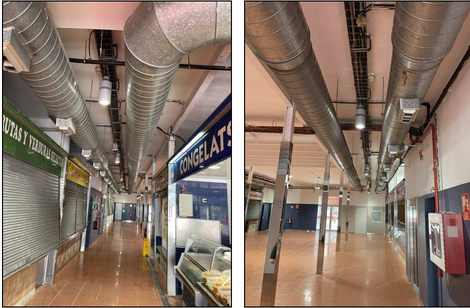
Conductes al interior del mercat Elements de difusió i retorn
