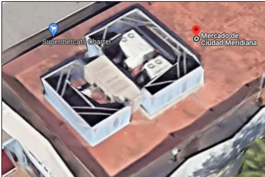
Unitats de clima roof-tops en recinte acústic
