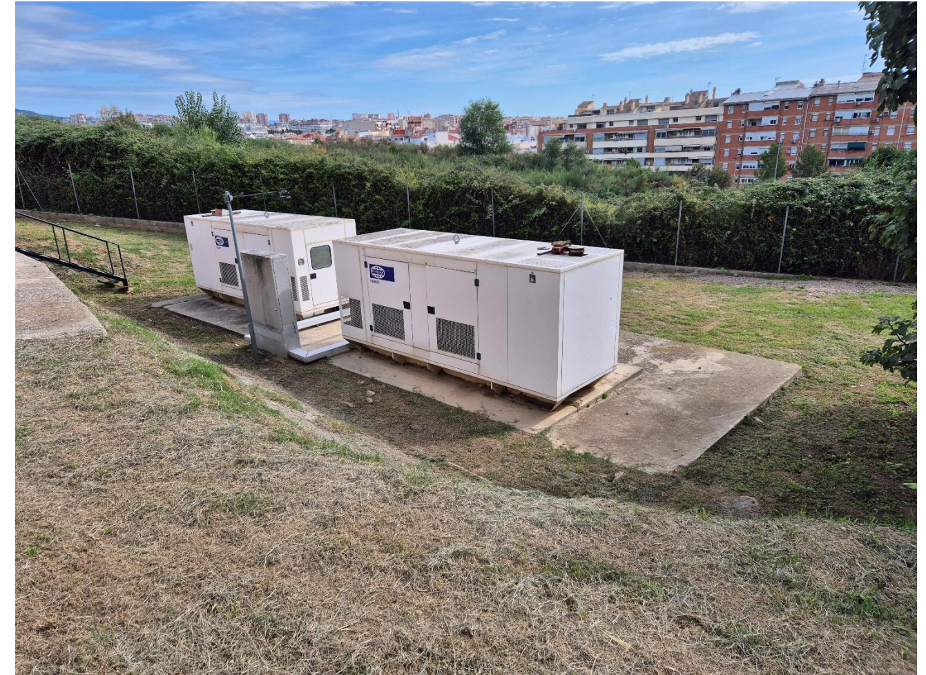
Grups electrògens actuals a retirar
