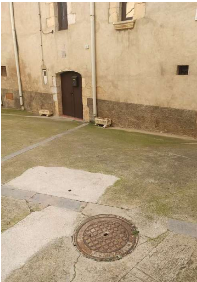
Estat del paviment de la Placeta
