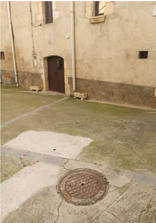
Estat del paviment de la Placeta
