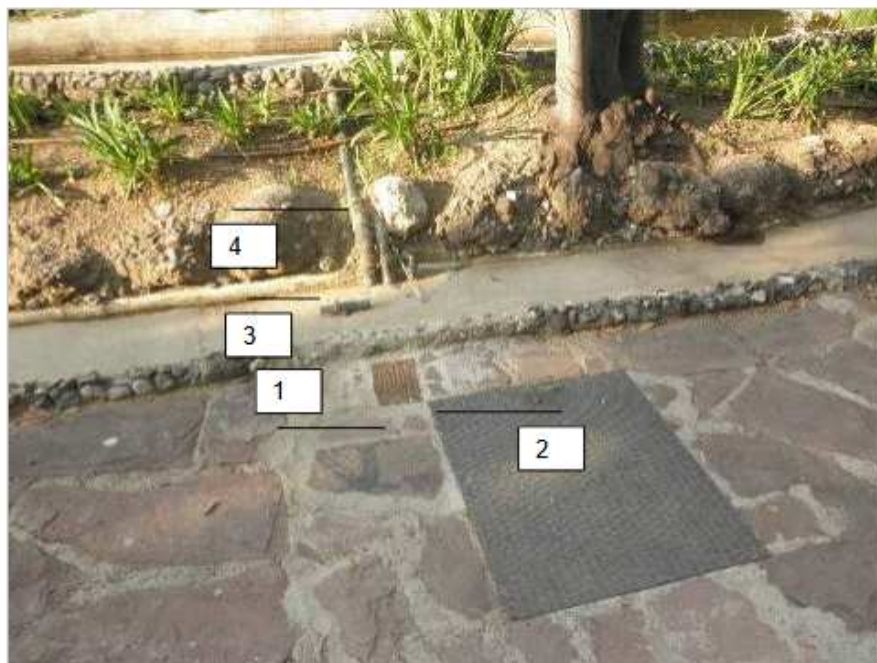
1 i 2. Arquetes amb claus de pas, 3. Impulsor del canal, 4. vàlvula antiretorn
