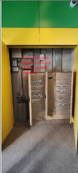
ESTAT ACTUAL QUADRE ELÈCTRIC
