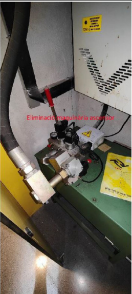
ESTAT ACTUAL QUADRE ELÈCTRIC
