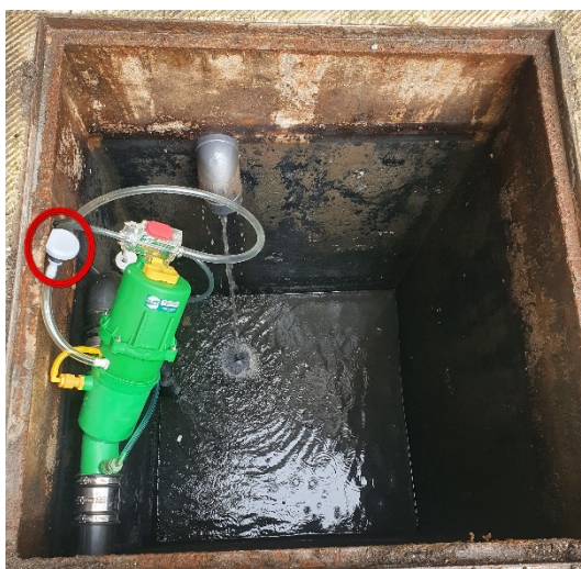
ventilació situat a l'interior de un pou
