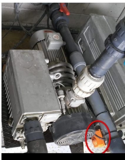
Termòstat antic muntat a la pròpia bomba
