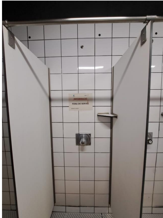
Fotografia 10: Dutxa fora de servei vestuari masculí abonats zona esportiva
