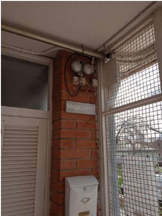
Sortida de tub a exterior aprofitant tub existent
