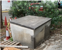
Casetó un es situarà la impulsió i extracció d'aire
