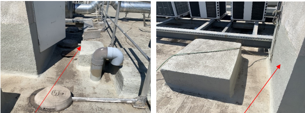
Punt de sortida de les canonades de gas frigorífic.
