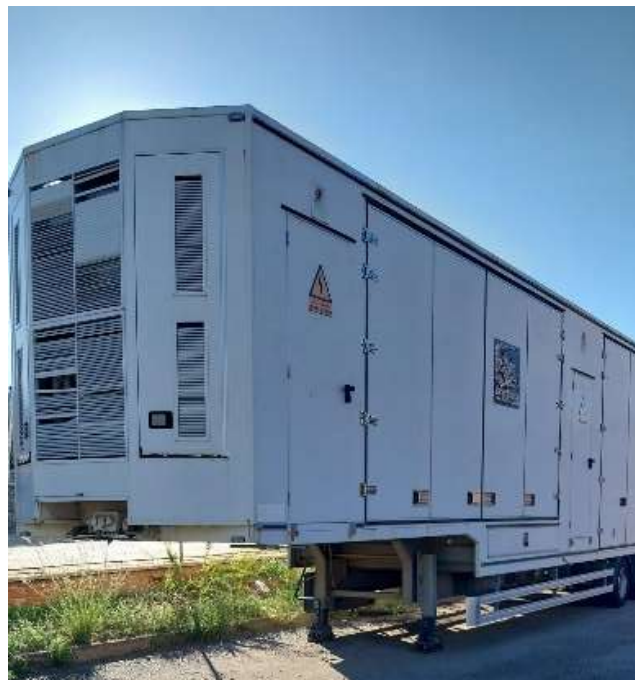
Figura 12. Fotografía subestación móvil.
