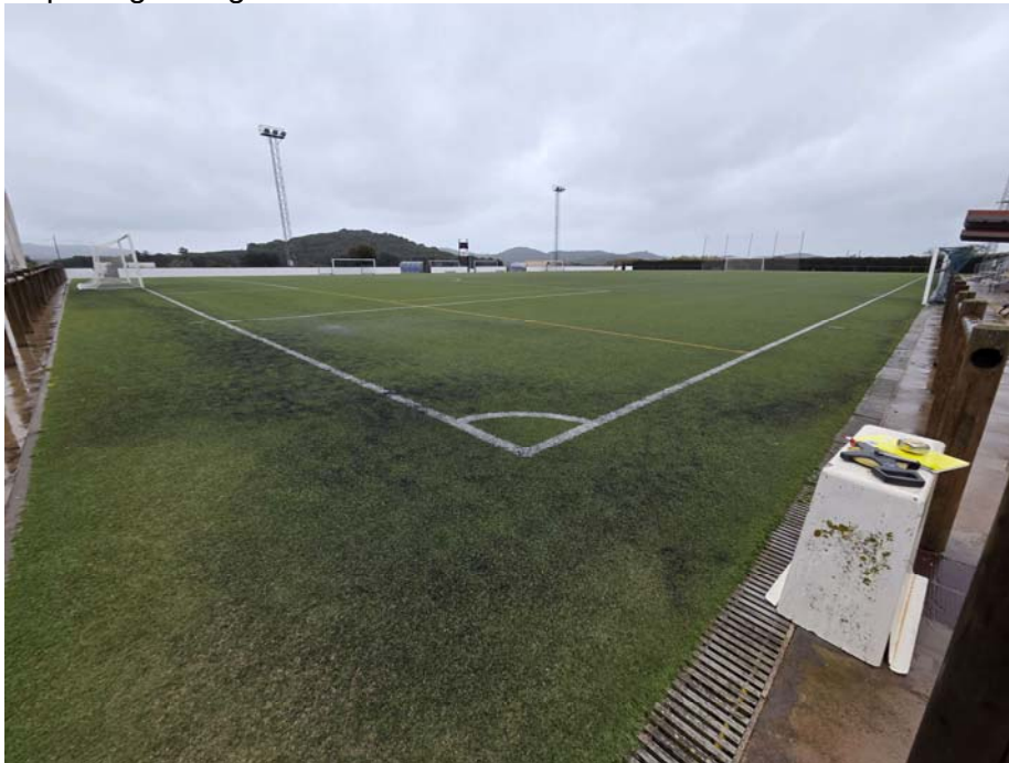
Foto 1. Vista general del camp de futbol. La degradació del fil de la gespa provoca que el cautxú no quedi intersticialment.
