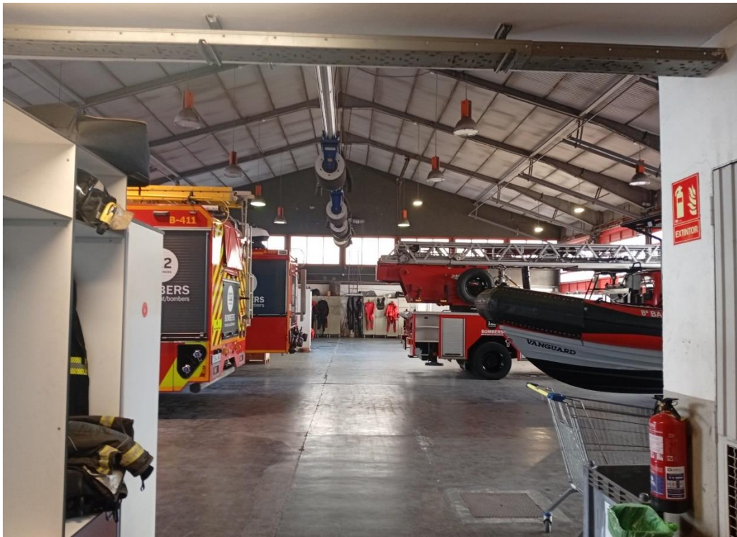
Imatges de l'estat de conservació de la sala d'útils
