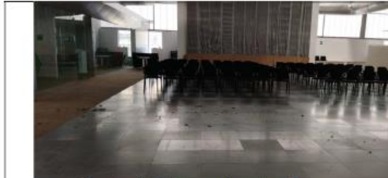
Restes dels despreniments a terra
