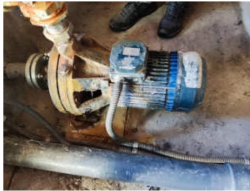
Fotografia 2 Detall de la bomba a substituir del pou de Vivers
