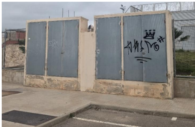
Armaris existents on es realitzarà el punt de connexió de la instal·lació fotovoltaica
