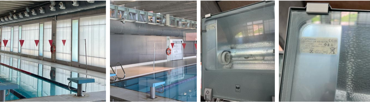
Enllumenat interior de la zona de piscina
