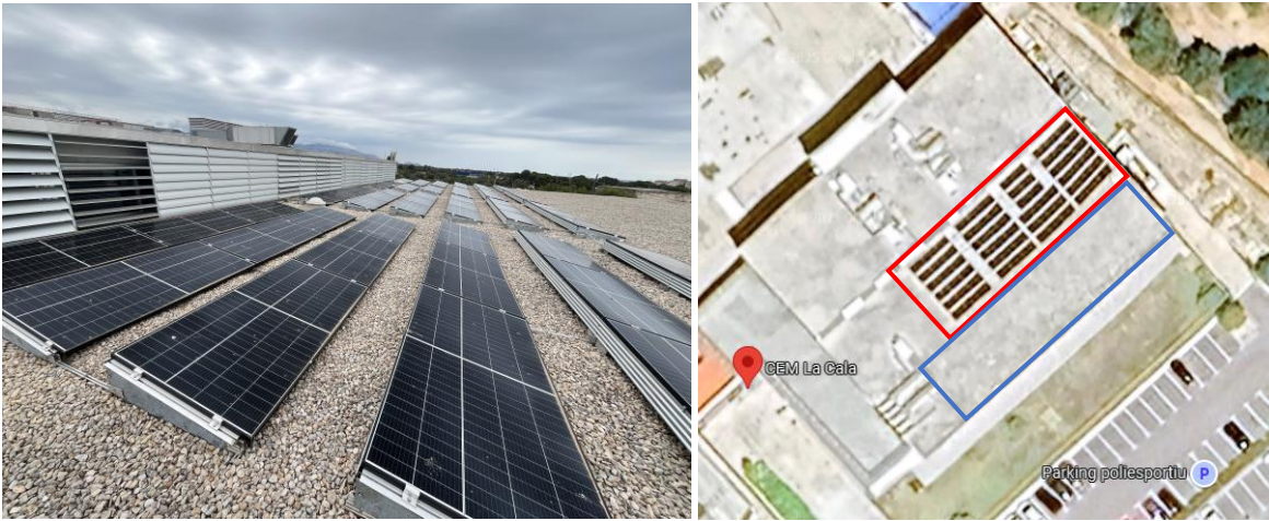
Instal·lació fotovoltaica existent
