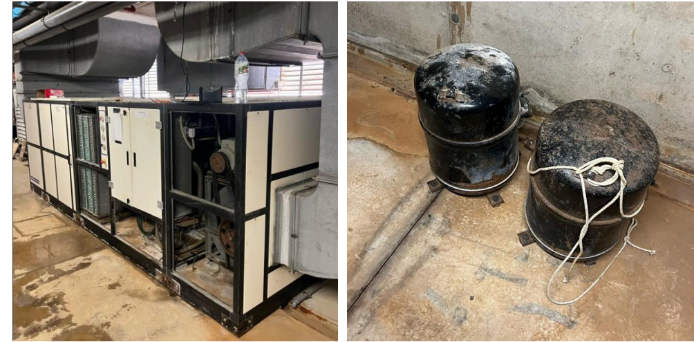
Deshumectadora i compressors existents
