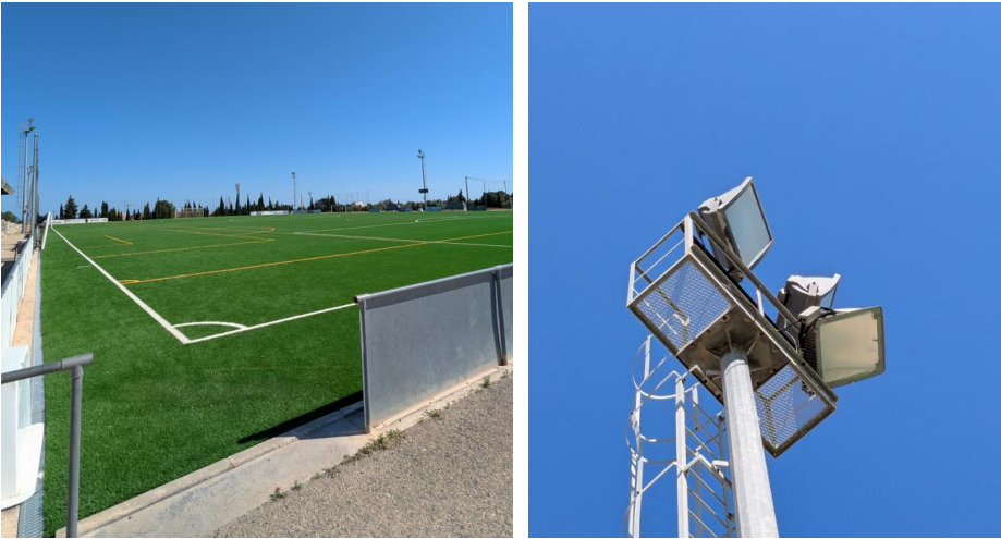
Torres de focus existents del camp de futbol 11
