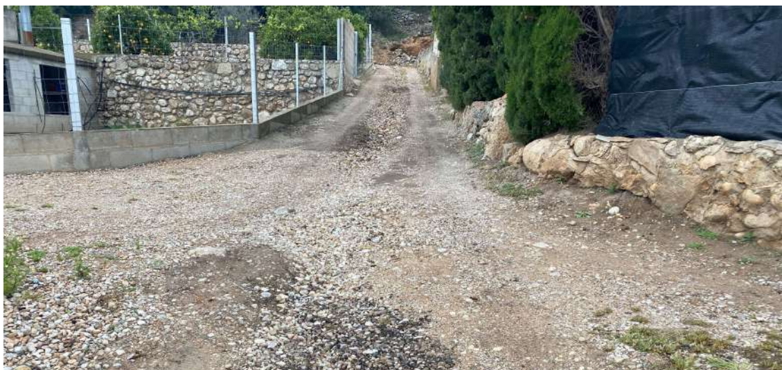
Imatges 3. Desperfectes al camí del Malpàs
