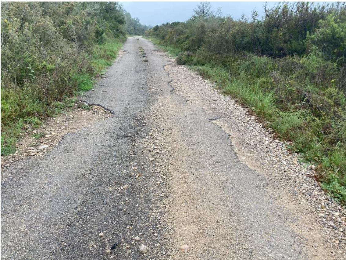
Imatge 7. Desperfectes camí Valldebous (baix) 2
