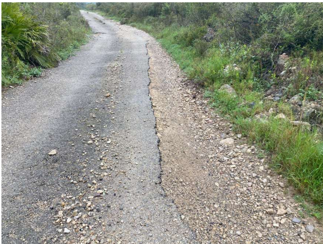
Imatge 8. Desperfectes camí de Valldebous (baix) 3
