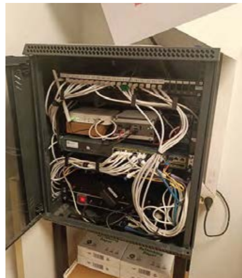
Rack informàtic existent
